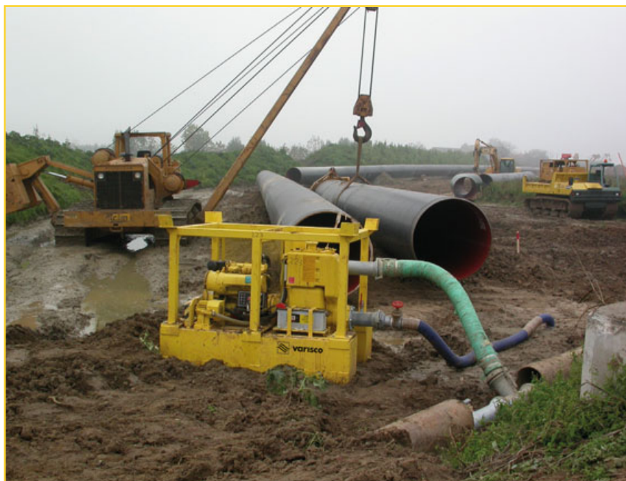
Drainage excavation for pipeline installation Grabenentwässerung für Gasleitungsverlegung Откачка воды из траншей для укладки газопровода
