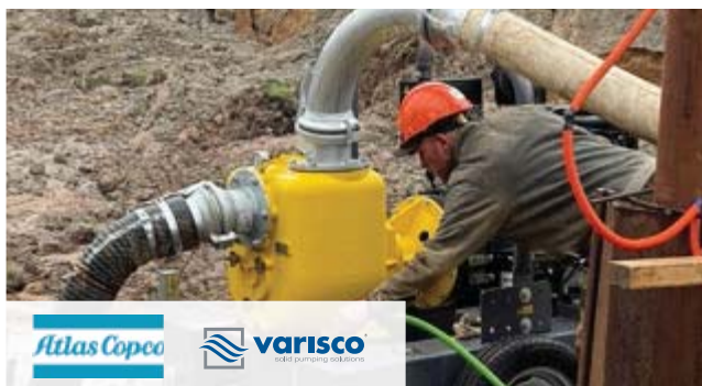
Мотопомпа Var Atlas Copco (Varisco) на объекте строительства береговой насосной станции
