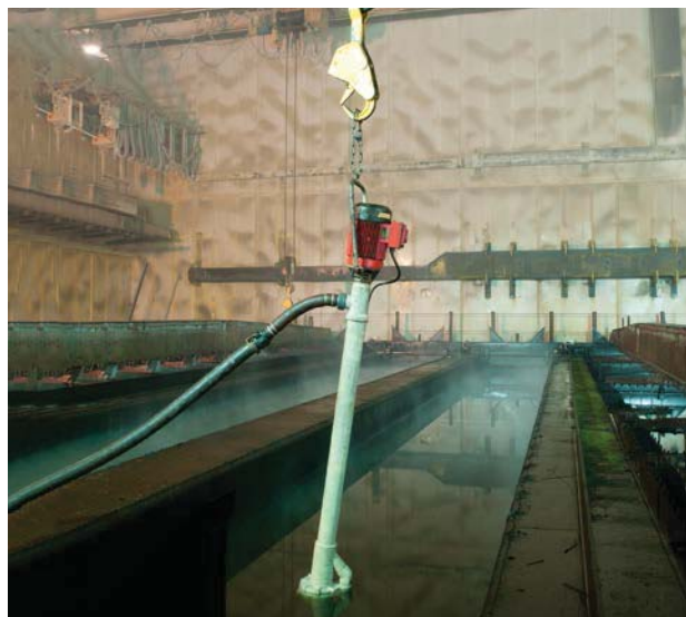
F 640 – Выкачивание разбавленной серной кислоты
